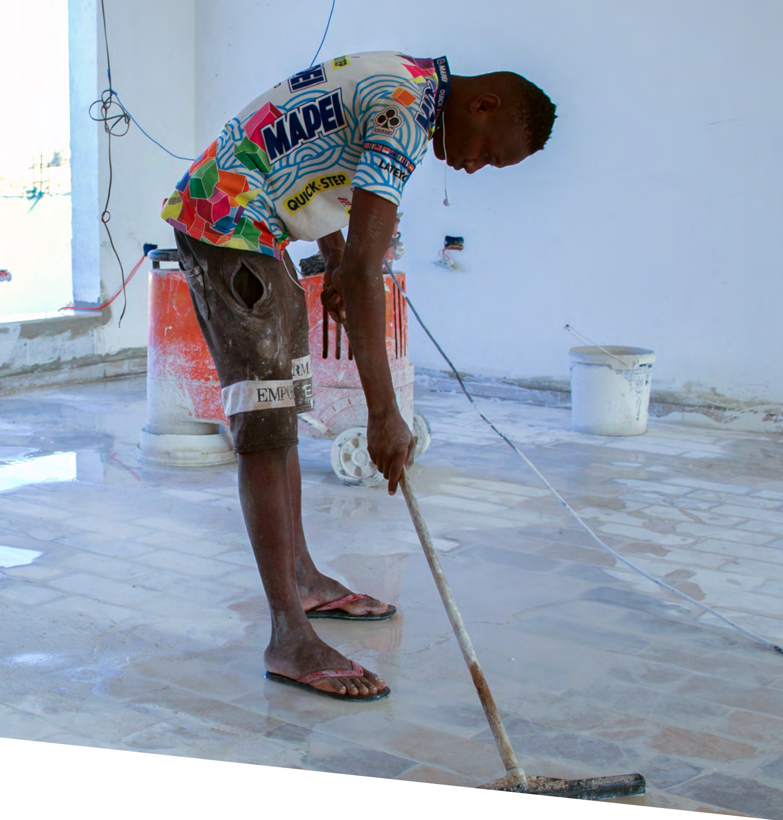
Crédit Photo : © MMC / Samuel Abraham Micheal Un travailleur originaire du Mali, nettoyant un chantier de construction. Zarzis, Tunisie, octobre 2021.
